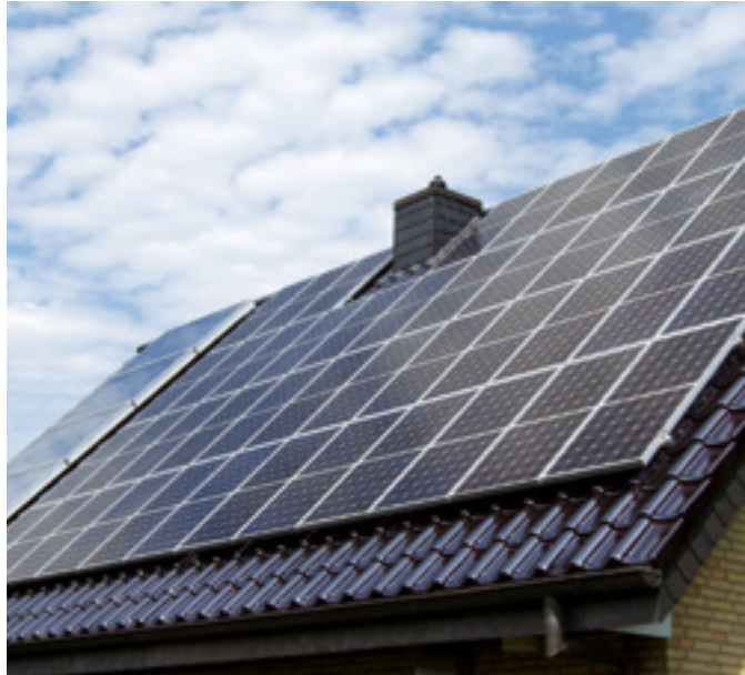
Photovoltaik-Anlage auf dem Dach eines Einfamilienhauses
