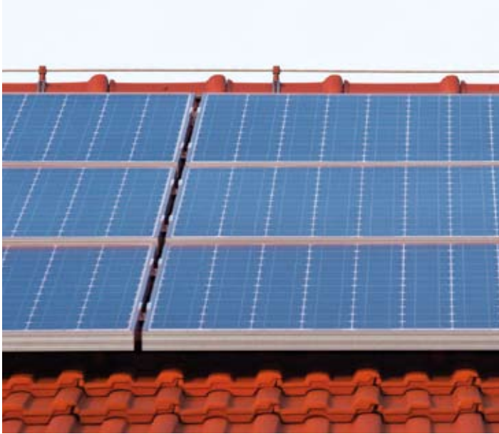
Montierte Solarmodule auf einem Dach; Quelle: BMU-Bilderdatenbank
